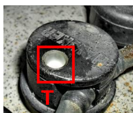
Indicateur de niveau Flotteur blanc affleurant = Niveau d'électrolyte OK
